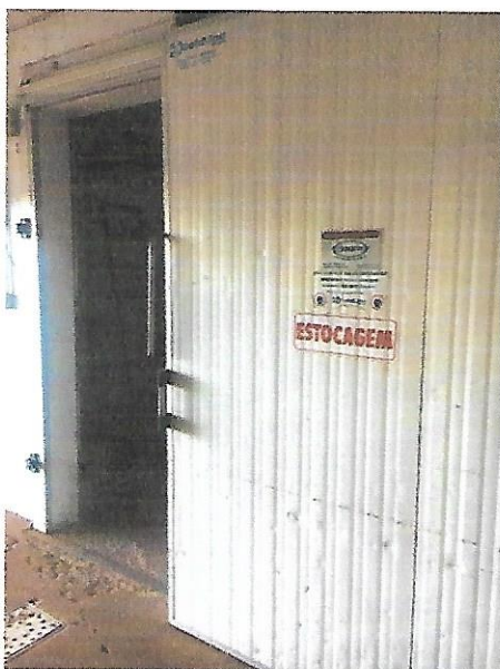
Foto 05 – Entrada da Câmara Fria de Miúdos
