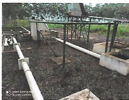
Foto 49 – Rede de Tratamento de Resíduos
