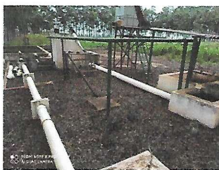
Foto 49 – Rede de Tratamento de Resíduos
