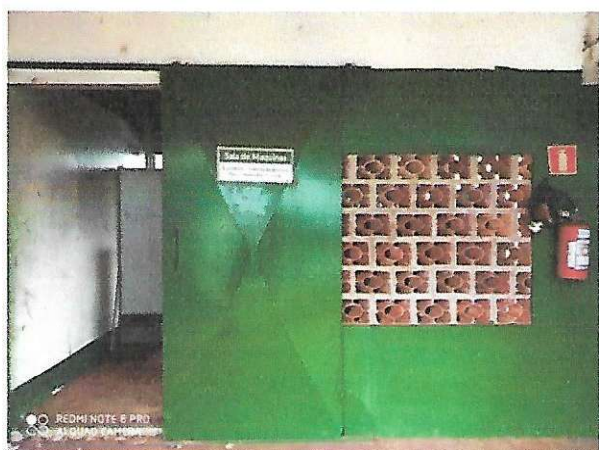
Foto 35 – Entrada da Sala de Máquinas
