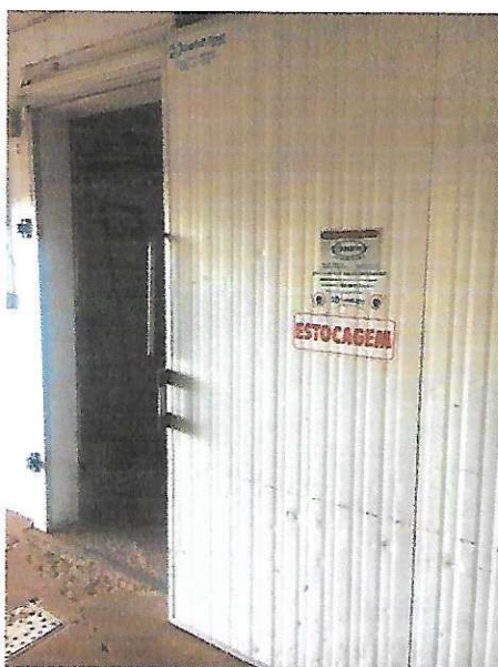
Foto 05 – Entrada da Câmara Fria de Miúdos
