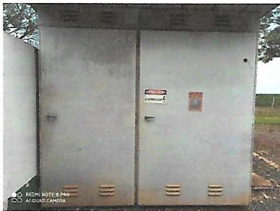
Foto 50 – Painel de Energia de Alta Tensão
